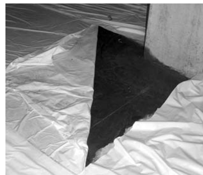
Fot. 2. Utrzymana wilgotność posadzki 3 tygodnie od wykonania – wilgoć widoczna na słupie betonowym
